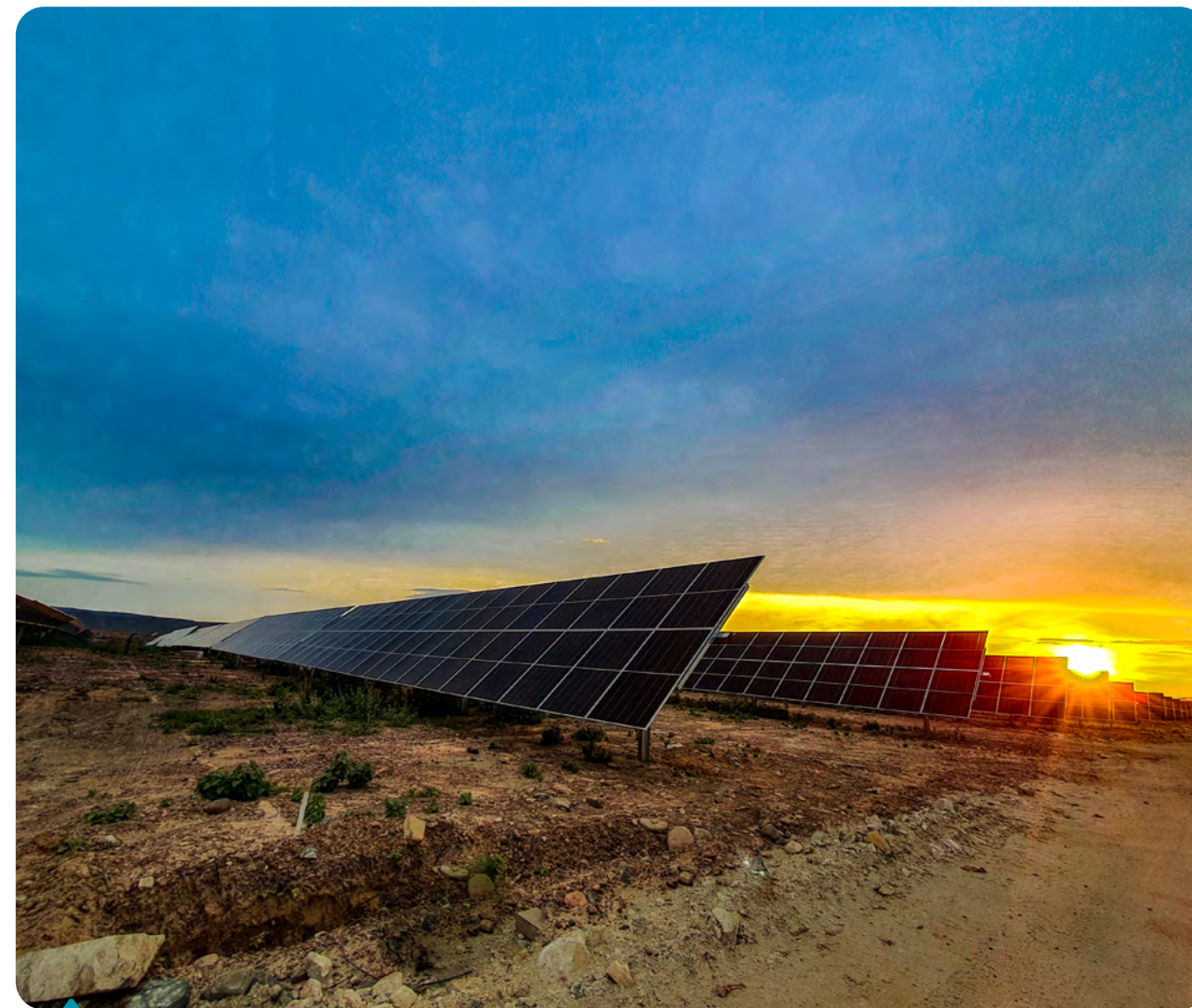
Futura I Solar Farm
