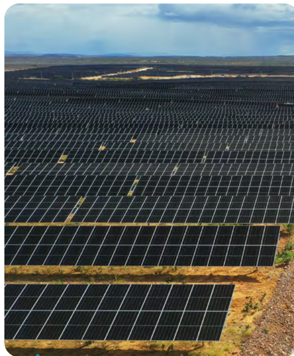
Parque Solar Futura I
