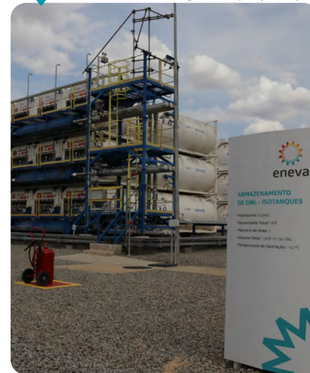
Armazenamento de GNL - Jaguatirica II (Março 2023)
