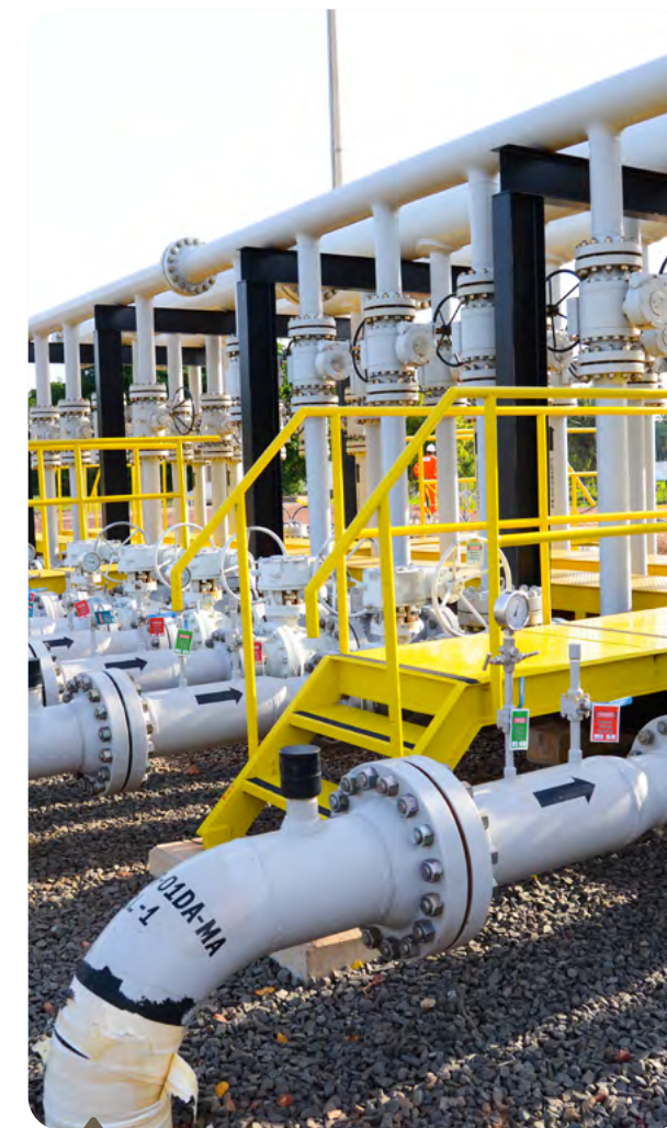
Gasodutos no Complexo Parnaíba
