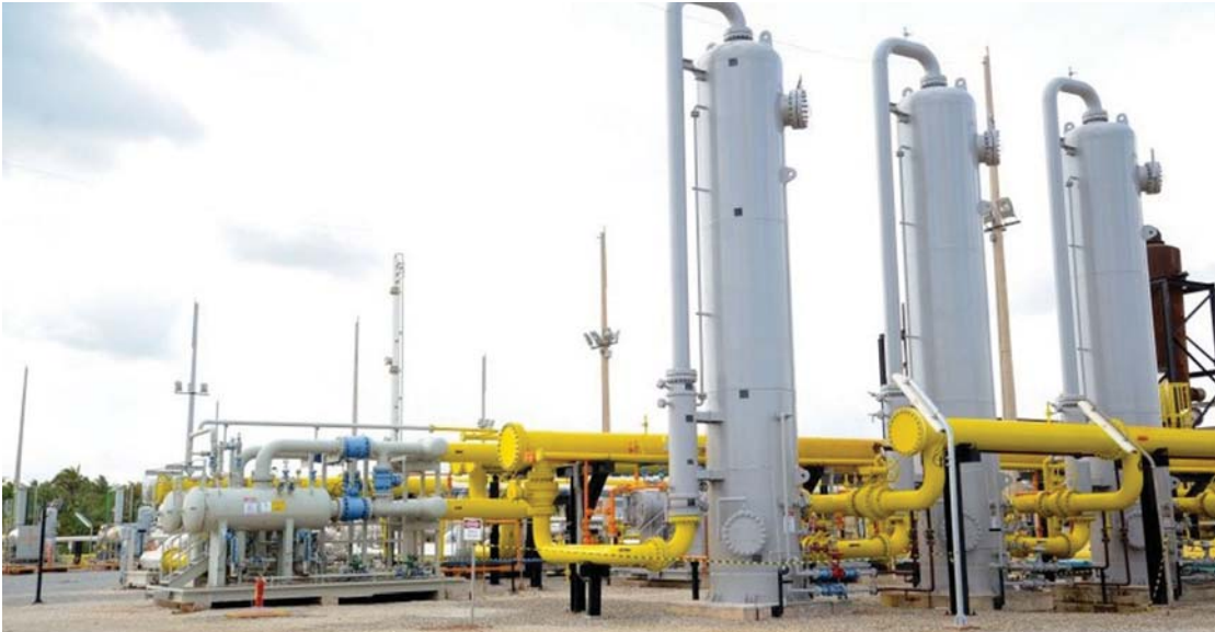
Uma das instalações de Unidade de Tratamento de Gás (UTG) da Eneva na Bacia do Parnaíba, no Maranhão
